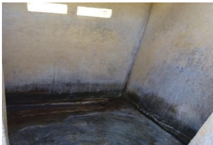
Image 1 : État des douches en novembre 2019 au centre IGBALA (Source : ONG Creuset-Togo, Coordonnateur du PASPEV)
