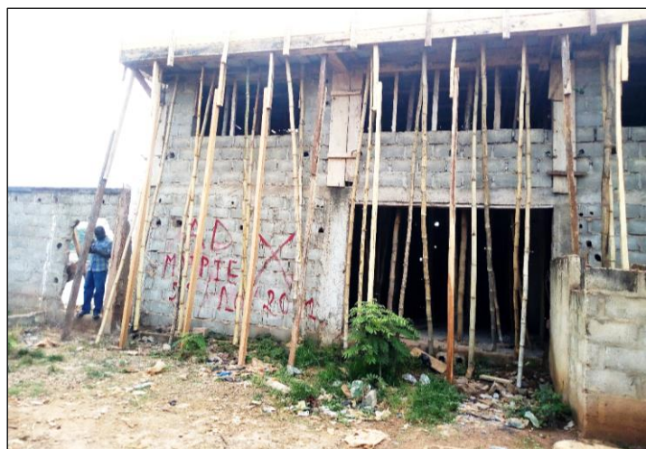
Photo 2 : Un chantier sans permis de construire de la mairie de Hiré Prise de vue : KOUADIO Toussaint, Avril 2022
