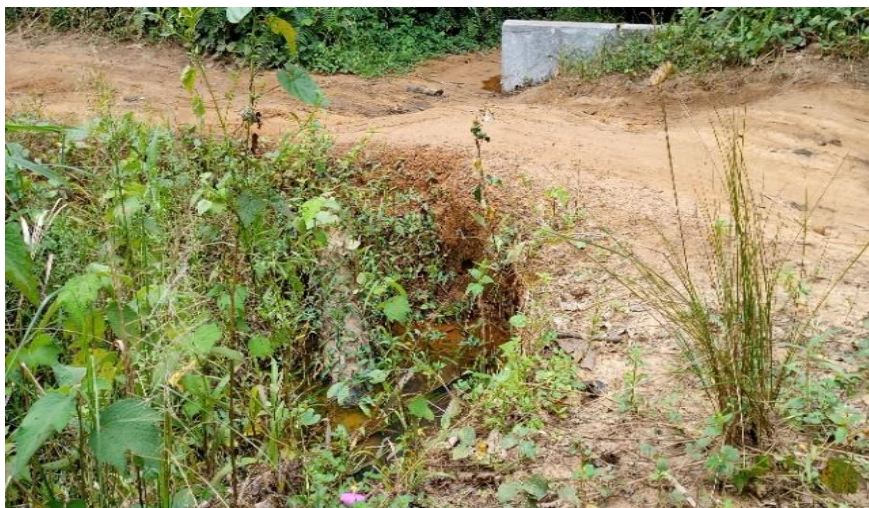
Photo 1 : Mauvais état de la voirie à Aboutou
